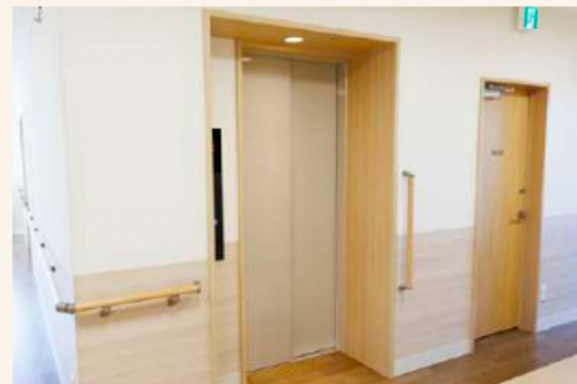
エレベーター
